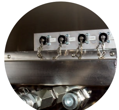
Anschlüsse zur Ventilsteuerung
